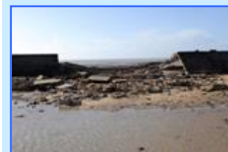
Rupture d'une digue à Saint-Martin-de-Ré en 2010 (tempête Xynthia)
