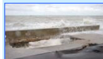
Rupture d'une digue à Asnelles en 2013
