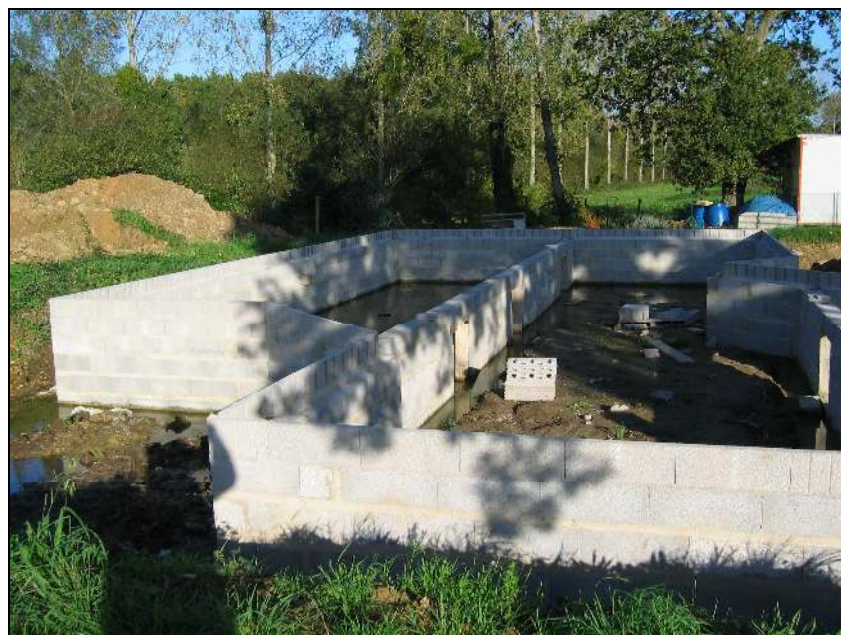
Construction à l'entrée de la commune de Sainte-Anne-sur-Vilaine en zone inondable du Plan de Prévention des Risques
